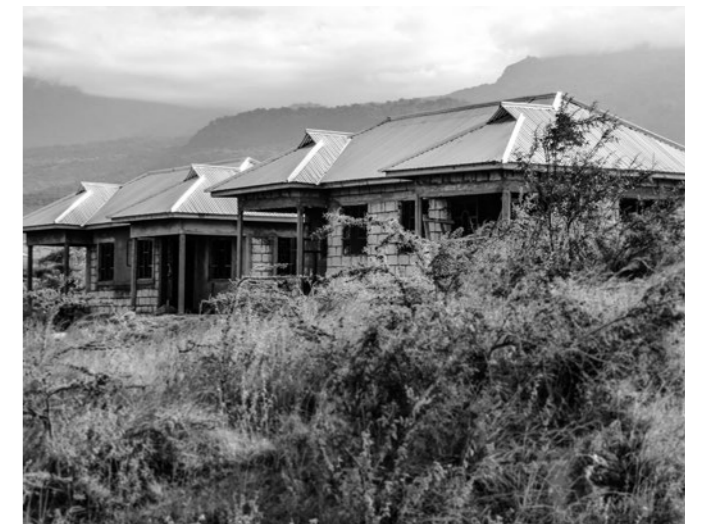
Die beiden Doppelhäuser an der Momella Secondary School können schon bald bezogen werden.
