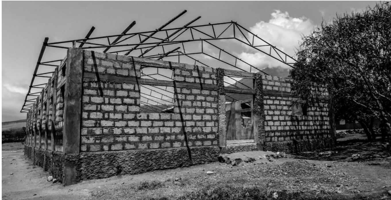
Bisher das grösste Bauwerk auf dem Campus: Die imposante Mehrzweckhalle im Rohbau.
